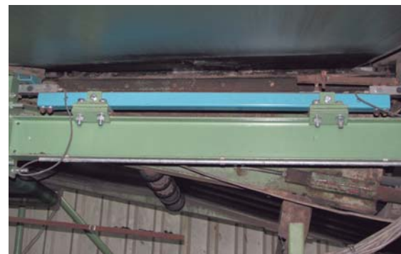
Afb. 3 De door Inadco aangebrachte weegcel onder de verzamelband
